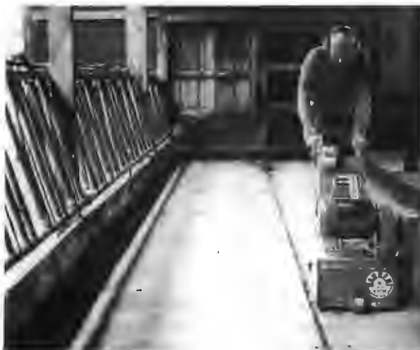
Bild 4: Glatte Betonböden können aufgeraut werden. Dies erhöht die Trittsicherheit für Mensch und Tier
