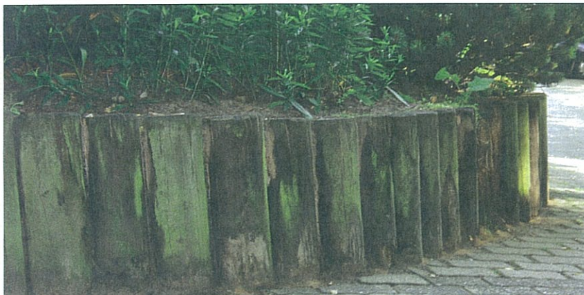
Abbildung 2 Unzureichend geschützte Holzpalisaden
