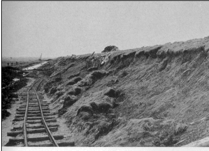
Abb. 28. Rutschungen an der Binnenböschung des Hauptdeiches vor dem Augustgroden an der Ostseite des Jadebusen Aufn. Forschungsstelle Norderney
