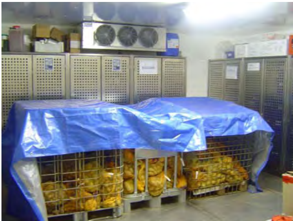
Abbildung 5: Kühlager im ttz Bremerhaven
