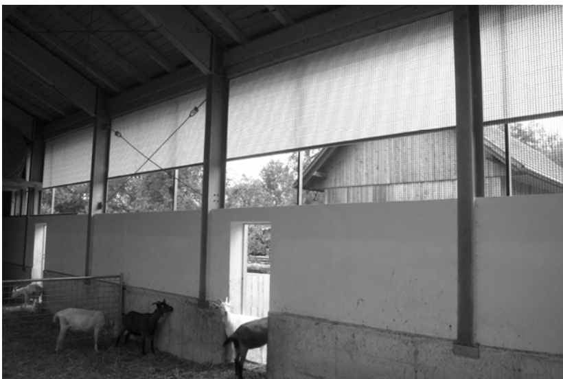
Abbildung 2: Windnetze im Ziegenstall sichern gute Lüftung
