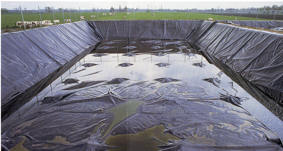
Abb. 15: Natürliche Schwimmdecke auf Rindergülle in einer Biogasanlage Floating cover on a plastic lined lagoon
