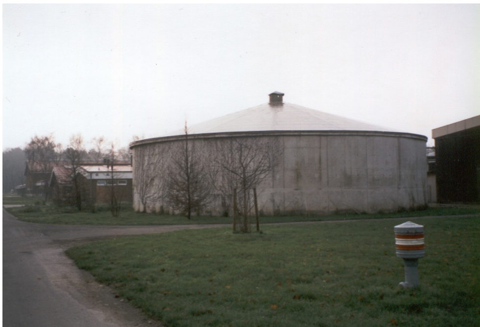
Abb. 19: Abdeckung eines Beton-Güllebehälter mit Holzfachwerk, Beplankung und Kunststoffbahnen Concrete slurry container with wooden framework with plank and plastic sheet segments as a cover
