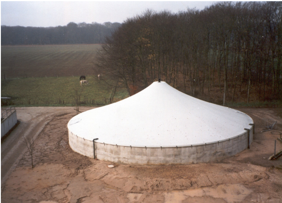
Abb. 20: Kunststoffzelt mit Zentralmast als Abdeckung auf Beton-Güllebehälter Plastic tent with centre pole as a cover of a concrete slurry container
