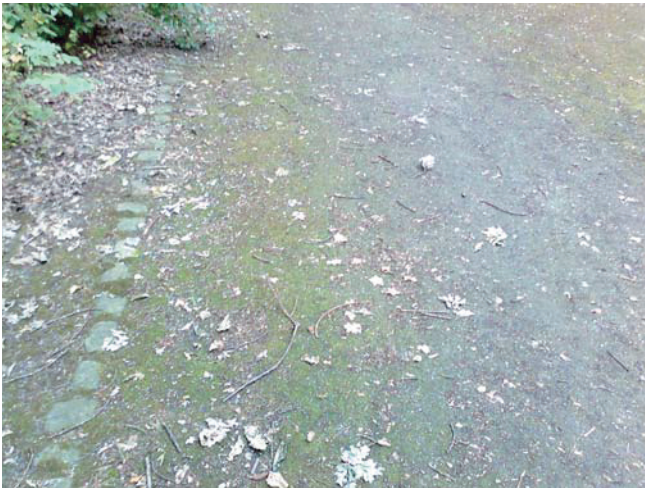
Abb. 1. Wassergebundene Wegedecke – ungepflegt mit starkem Algenbesatz.
