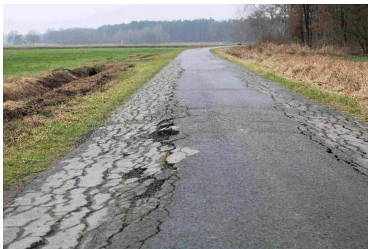
Foto 1: Für den Ausbau vorgesehene Asphaltstrecke im Lichtenmoor mit den Moorgebieten häufig zu beobachtenden Sackungen und Seitenabbrüchen
