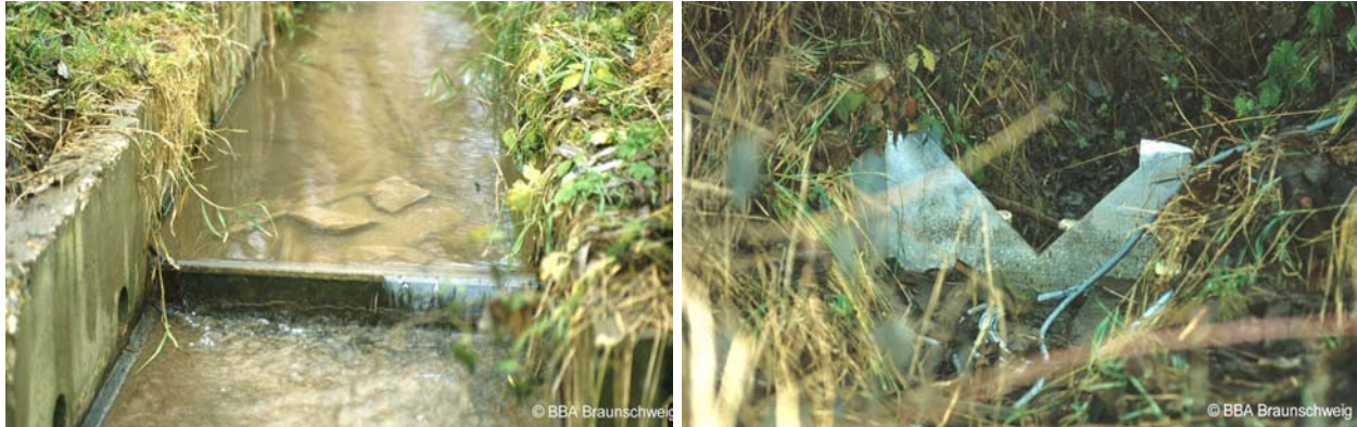
Abb. 2 In den Oberflächengewässern eingebaute Durchlässe zur Entnahme von Wasserproben und zur Messung der Pegelhöhe
