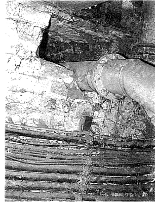
Abbildung 27: Undichtigkeiten im Kellerbereich eines Lagers
