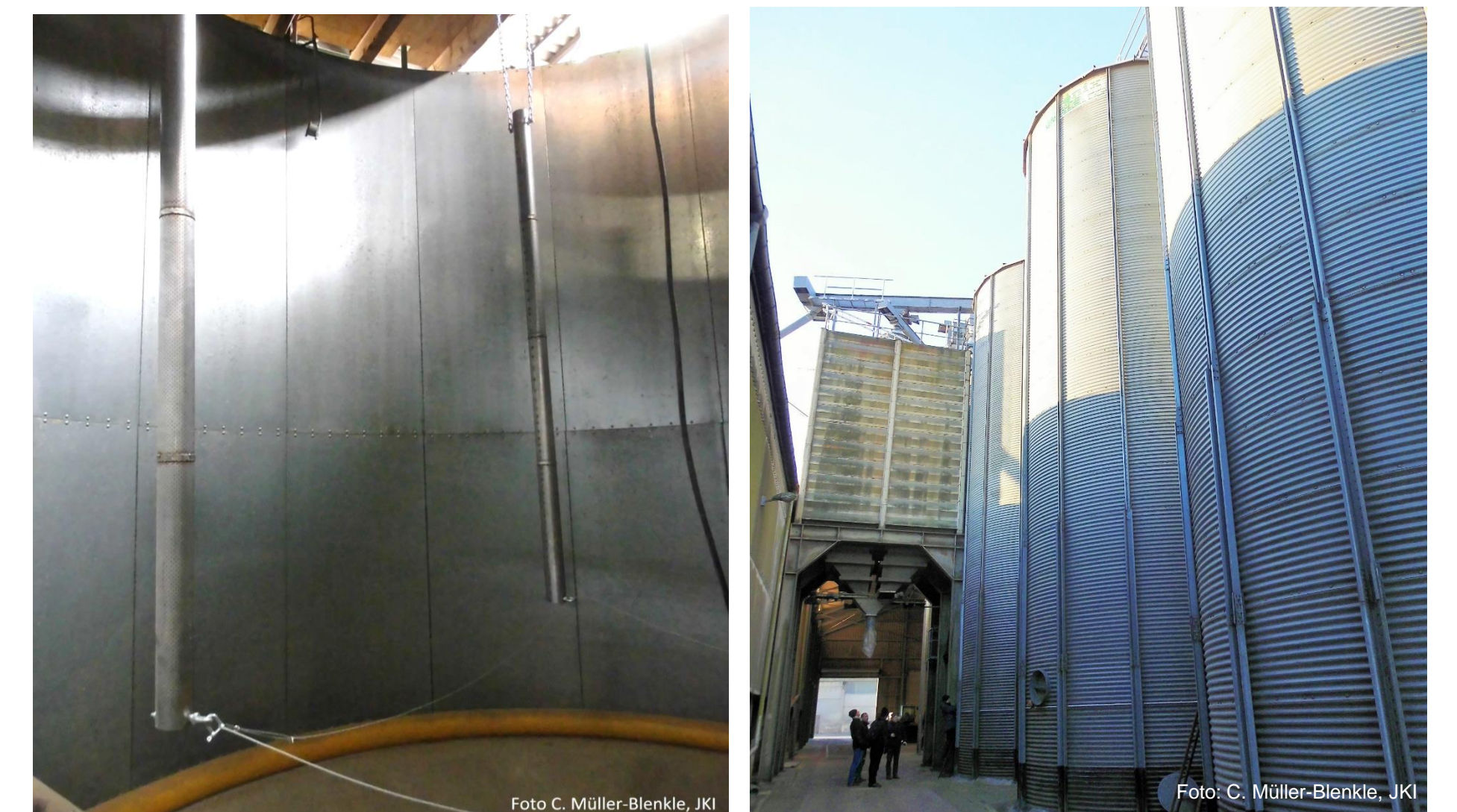
Installierte „Beetle Sound Tubes“- in einem noch leeren 75 t Silo (li.) und 300 t Versuchssilo von außen (re.)
