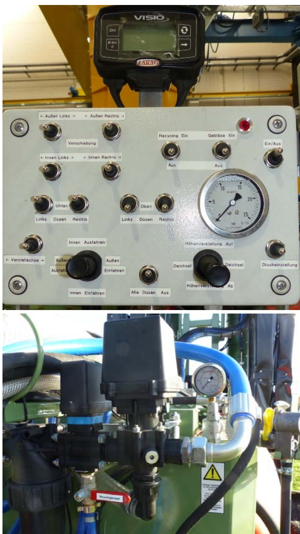
Abb. 12 und 13: Schalt-Tableau (oben) mit Fernmanometer und Kreuzhebeln für die Hydraulikfunktionen. Blockarmatur mit Druckregler, Recyclingventil und Druckfilter.
