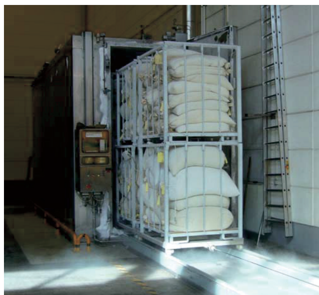
Abb. 1. Gedämmte Tiefkühlkammer der Firma Guttruff zum Frosten insbesondere von Tee und Gewürzen gegen vorratsschädliche Insekten; seit 1993 in Betrieb; gesackte Ware auf fahrbarem Gestell zum Befüllen der Kammer; Zieltemperatur im Kern der Ware -18^{\circ}\text{C} ; Einwirkzeit 12 Stunden bis 36 Stunden (je nach Wärmeleitfähigkeit des Produkts); ca. 3\text{ m}^3 bis 5\text{ m}^3 Flüssigstickstoff oder flüssige Luft pro Behandlung mit zeitweilig -80^{\circ}\text{C} außerhalb der Ware; Kosten bei ca. 1000 €/t; Zulassung nach Pflanzenschutzgesetz nicht erforderlich.
