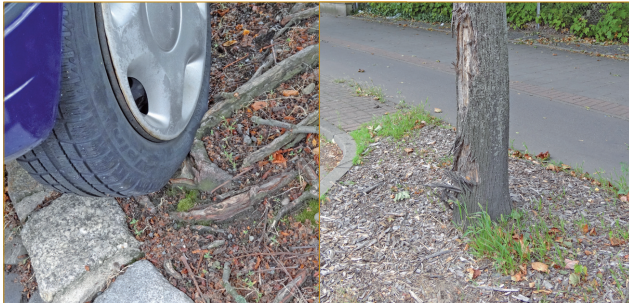
Abb. 6 - 7: Wurzelverletzungen und Stammschäden sind Eintrittspforten für Pilzsporen
