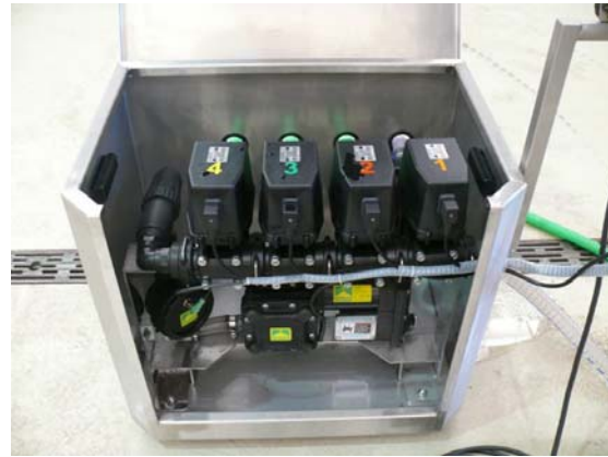
Abb. 3: Die Dosierventile (drei) sind mit Durchflussmesser und Pumpe in einem stabilen Edelstahlgehäuse untergebracht.
