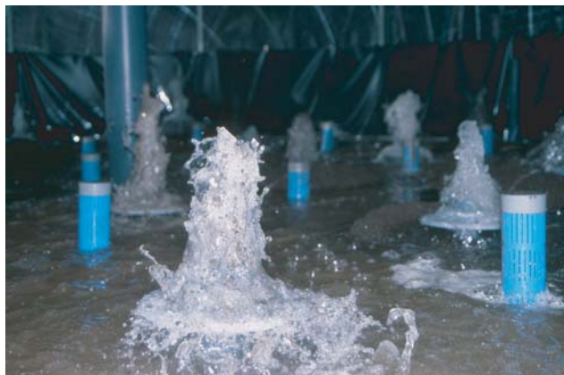
Abb. 3.5. Filter in Betrieb
