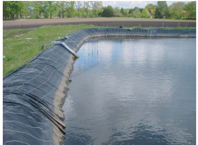
Abb. 2.4. Filter in Betrieb
