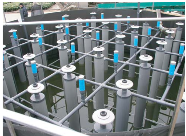
Abb. 3.2. Filter vor dem Einfüllen des Lavagranulats
