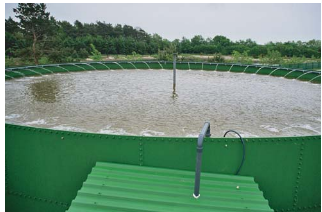
Abb. 2.6. Filter in Betrieb (Bauart: Stahltank)
