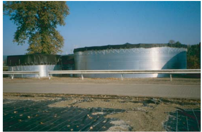
Abb. 5.5. Reinwasserbecken als Stahltank (rechts) mit Abdeckung
