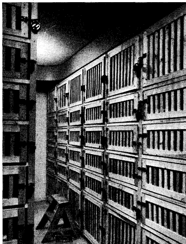
Bild 9. Kaltraumanlage mit bewegter Kühlung An der Decke über den Lagerfächern ein Luftkanal Hersteller: Linde , Sürth
